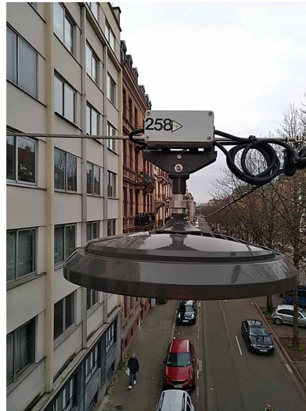
Vue du luminaire sur la caténaire et du réseau électrique aérien
